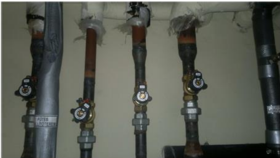
11. A hőszabályozó központ a korszerűsítése után
