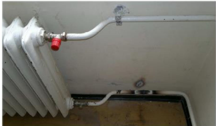
12. A hőleadók szabályozó szelepeinek a korszerűsítése után
